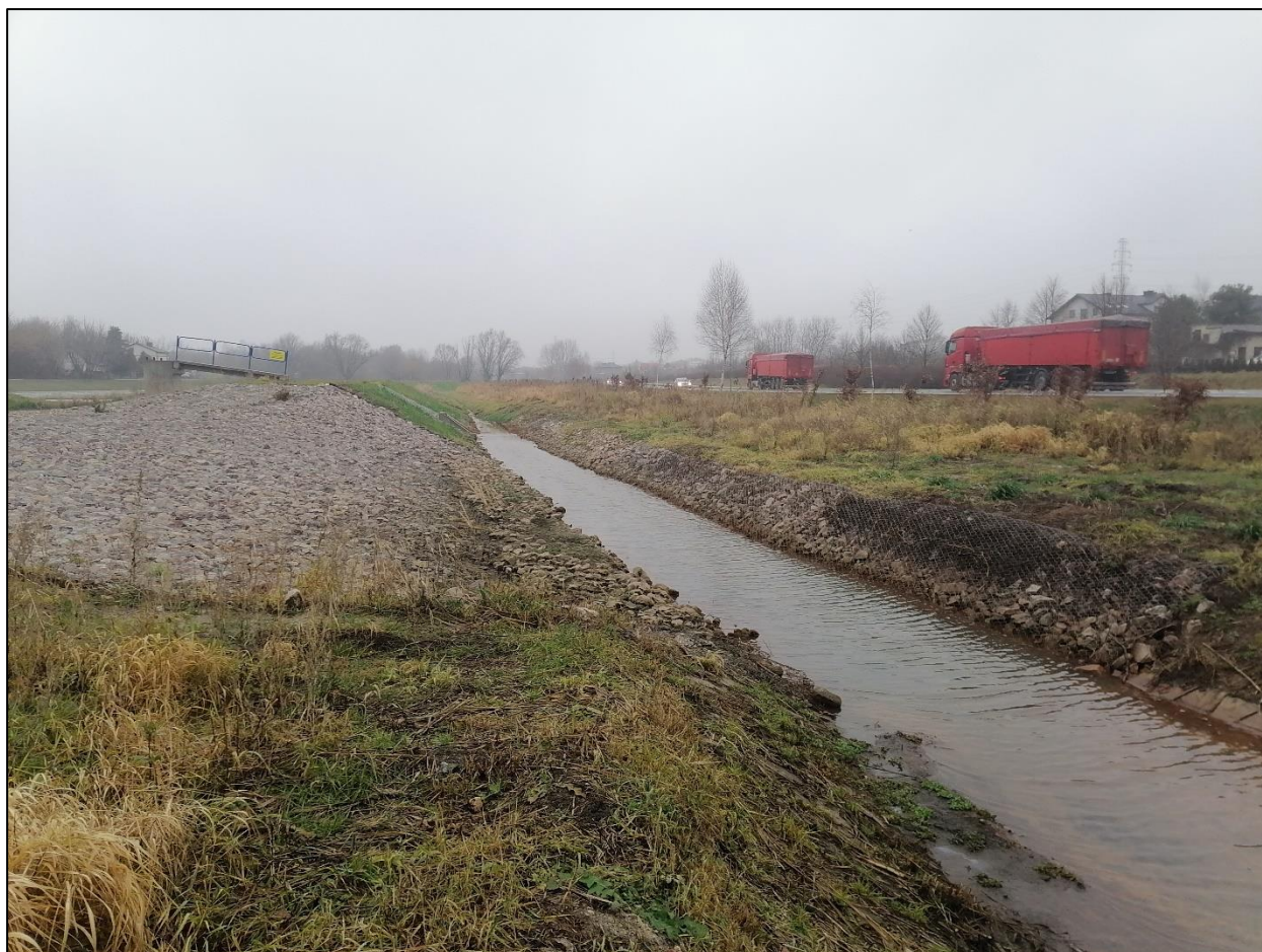
Zdjęcie 11 Przelew zrzutowy polderu zalewowego na rzece Cerekwiance (autor: B. Latoszek)
