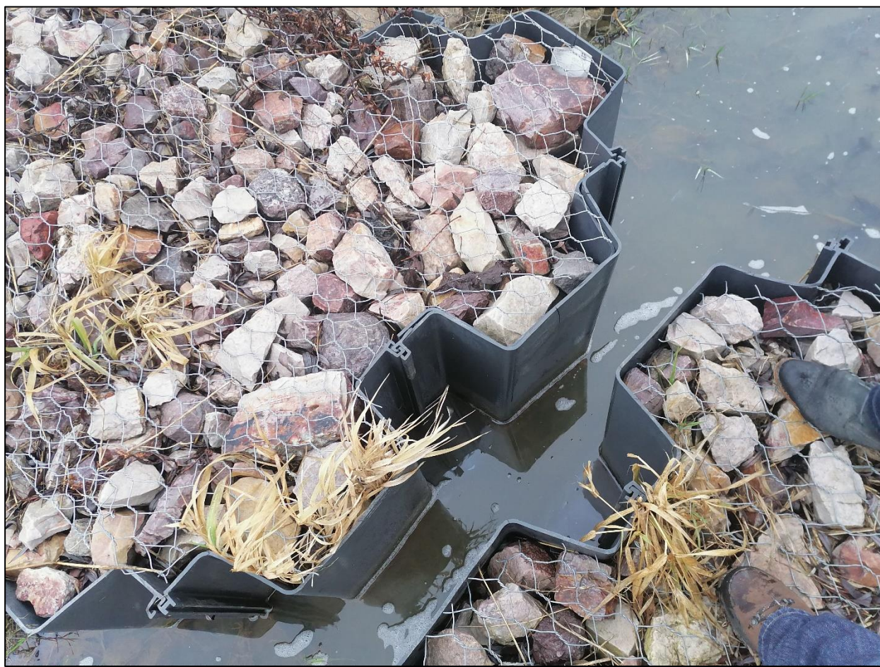
Zdjęcie 1 Szczelina kalibrująca przepływ w korycie rzeki Cerekwianki (autor: B.Latoszek)
