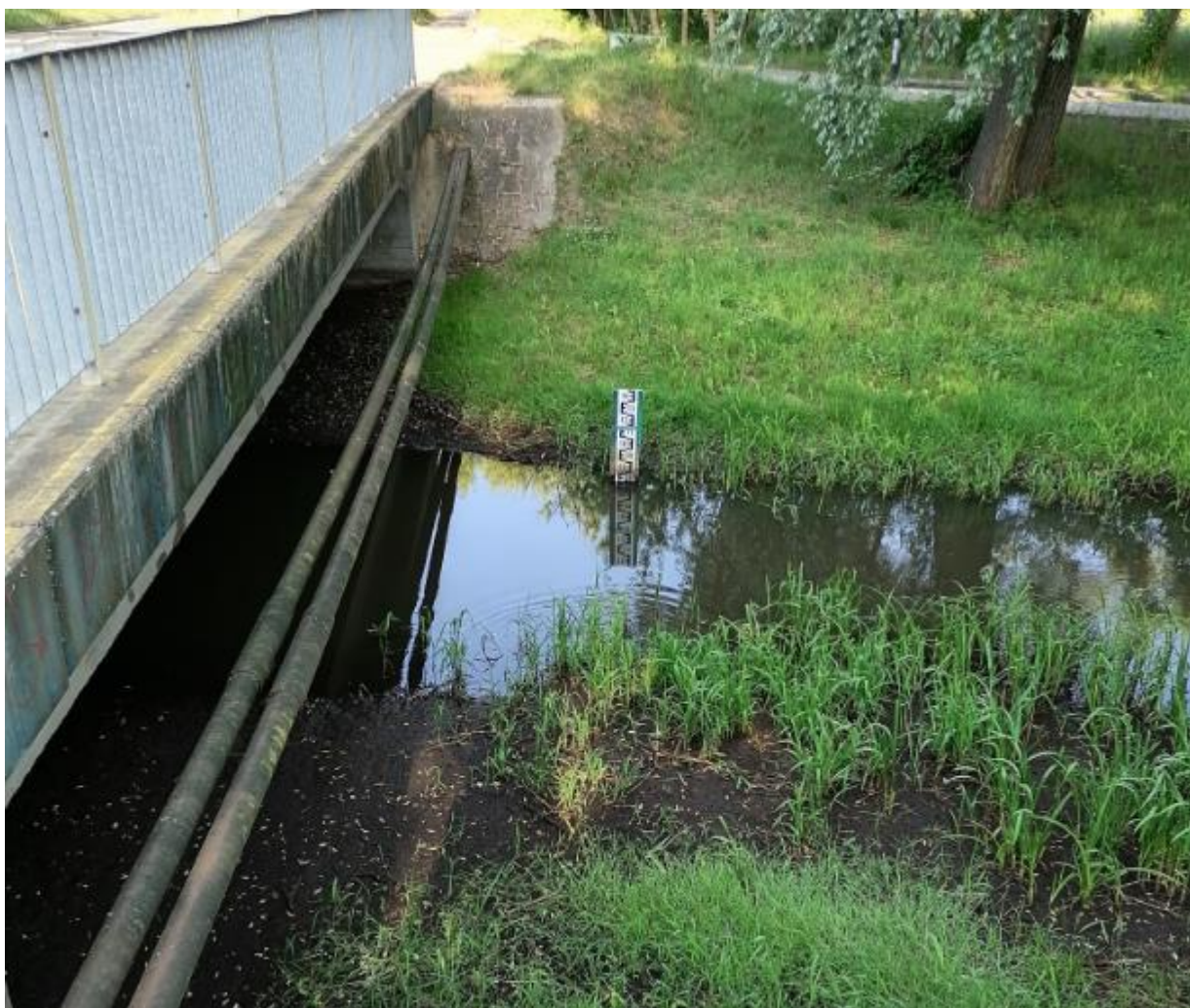
Zdjęcie 4 Posterunek wodowskazowy w korycie rzeki Mlecznej – dopływ do stawów kolmatacyjnych i zbiornika Borki, rejon ul. Suchej
