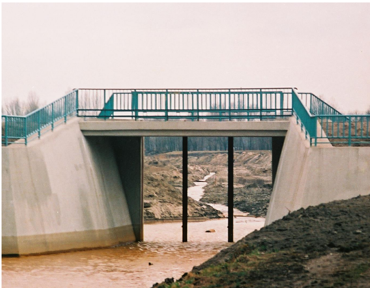
Zdjęcie 20 Widok przyczółków jazu zbiornika/zalewu Borki w czasie prowadzenia prac budowlanych (źródło GOOGLE EARTH, MAXXON)
