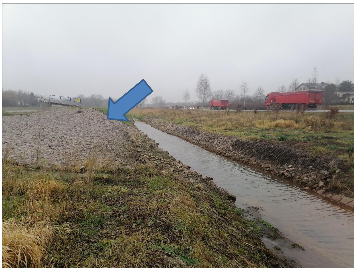
Zdjęcie 5 Przelew zrzutowy polderu zalewowego na rzece Cerekwiance (autor: B. Latoszek)
