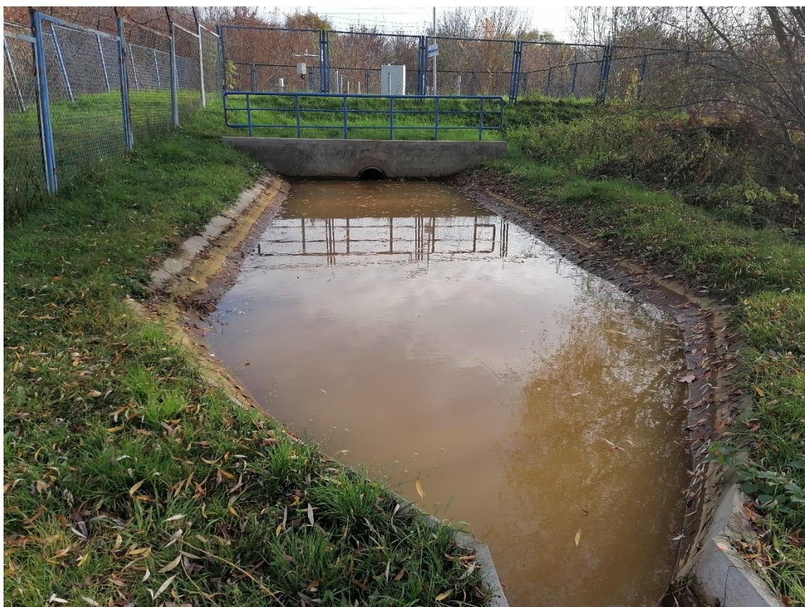
Zdjęcie 6 Wyjście z pompowni do kanału A0
