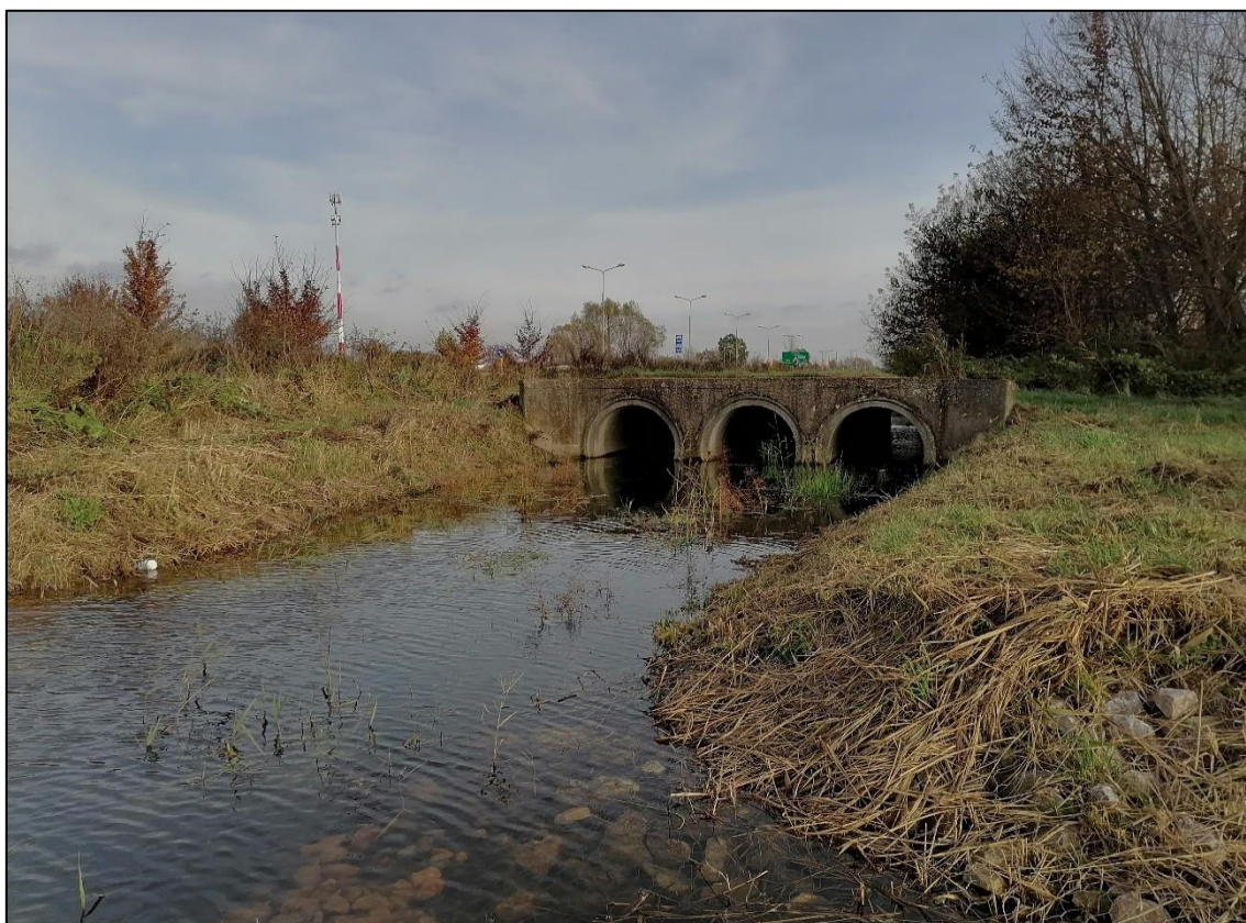
Zdjęcie 16 Miejsce prowadzanego pomiaru D_05 (odpływ)
