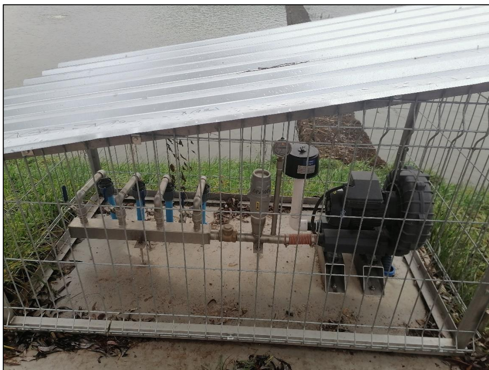
Zdjęcie 4 Dmuchawa napowietrzająca z systemem przewodów napowietrzających
